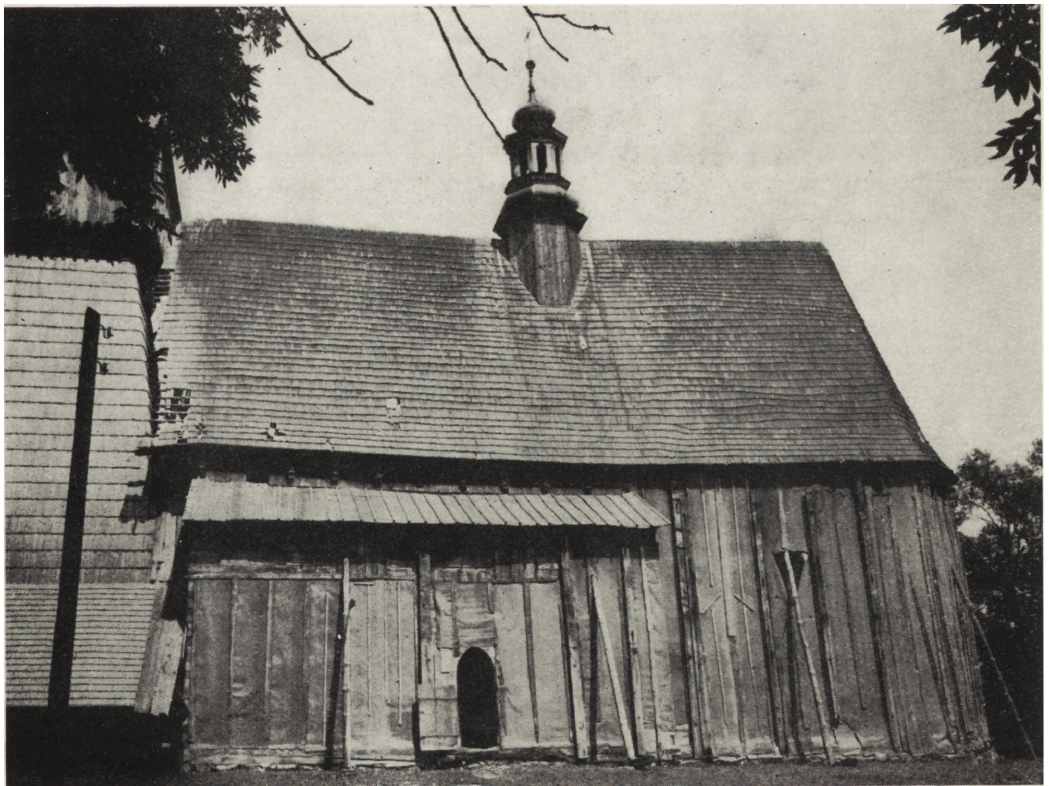
3. Haczów. Dawny kościół par. Widok od pd. — prowizoryczne zabezpieczenie ścian po rozebraniu sobót i zdjęciu oszalowania. Stan z 1962 r. (fot. Jerzy Langda, zbiory IS PAN)
