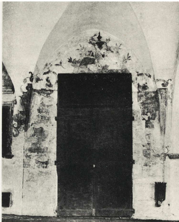
Ryc. 18. Tarnów, odkryty i zakonserwowany. malowany portal w podcieniu domu Rynek 20 z końca XVI wieku. (fot. W. Werner)
