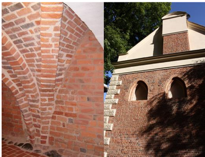
Ryc. 2. Budynek dawnego klasztoru – gurdy sklepienia w piwnicy oraz elewacja północna z częściowo zrekonstruowanymi po remoncie gotyckimi arkadami (fot. A. Cicha)
