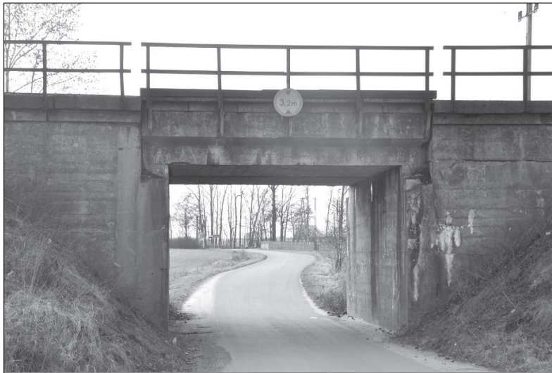
Fot. 11. Przejazd pod linią kolejową między miejscowościami Dziewulin a Karczówek w gminie Szadek – ograniczenie wysokości pojazdów do 3,2 m Źródło: zdjęcie I. Pecyna, 2016
