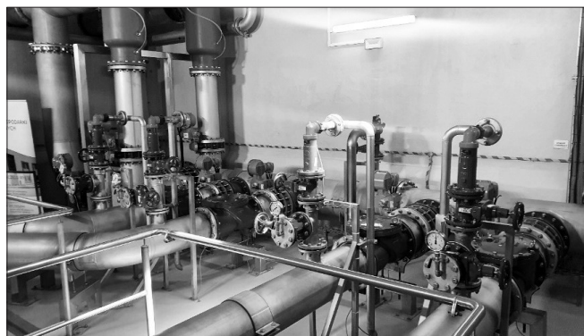
Nowe pompy w zmodernizowanym ujęciu powierzchniowym „Grabówka” Fot. K. Buczkowski
