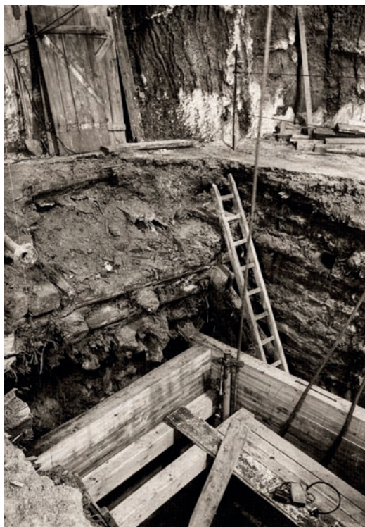
Fot. 14. Przebudowa szybu na głębokości 64 m, widok w kierunku południowo-wschodnim, fot. Filip Kalwajtys, 1988 r.
